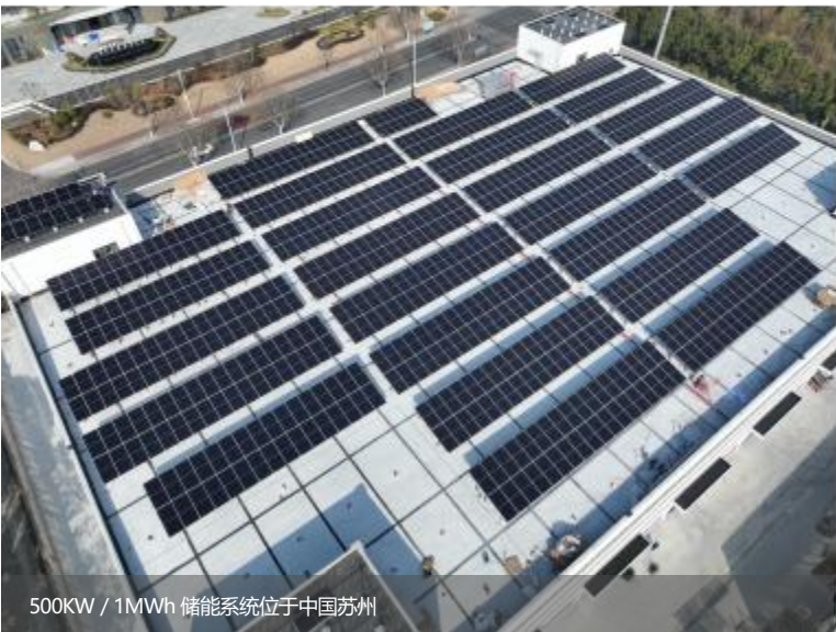
500KW / 1MWh 储能系统位于中国苏州
