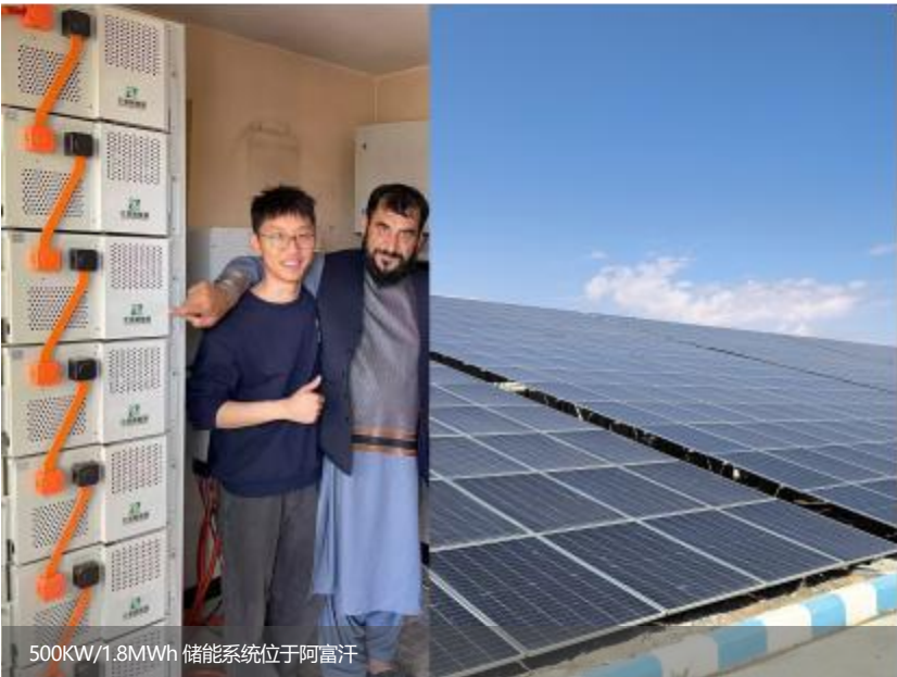
500KW/1.8MWh 储能系统位于阿富汗
