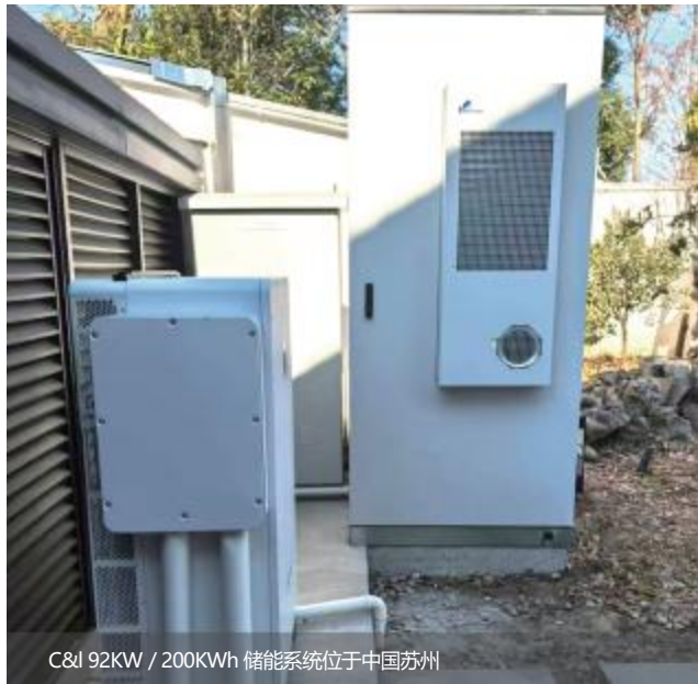
C&L 92KW / 200KWh 储能系统位于中国苏州
