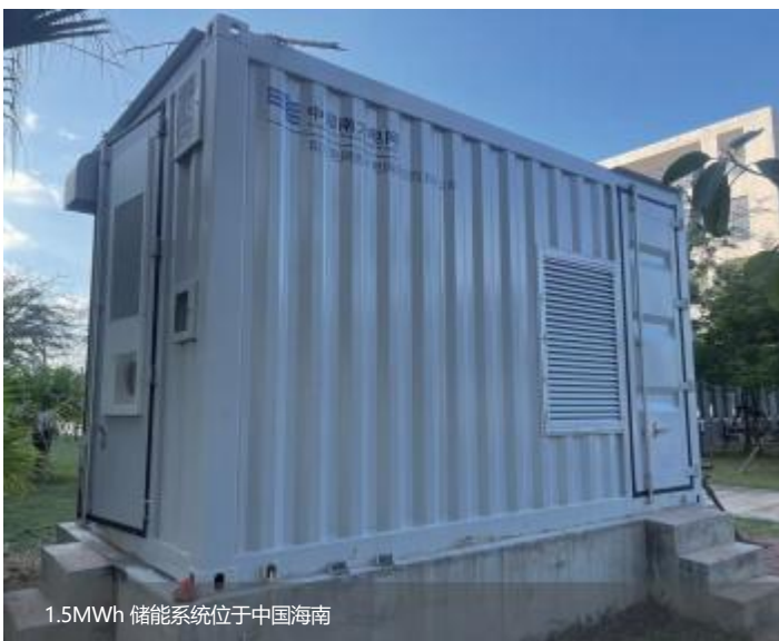
1.5MWh 储能系统位于中国海南
