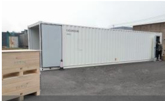
500KW/1.66MWh 储能系统位于德国
